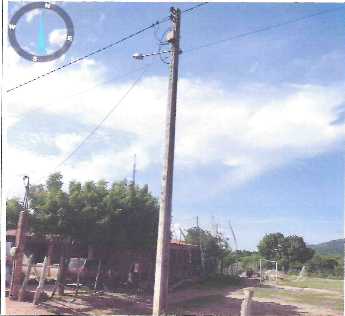
Figura 3: POSTE DA COMPANHIA ELÉTRICA PRÓXIMO
